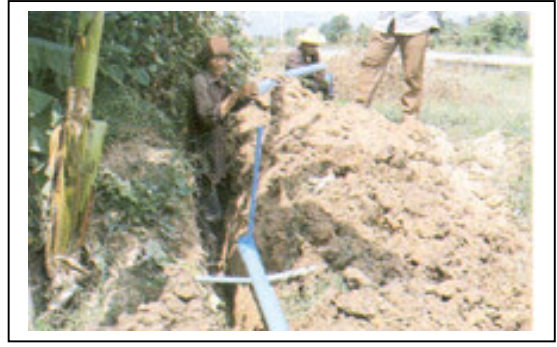
ท่อในระบบท่อเมนจ่ายน้ำ
